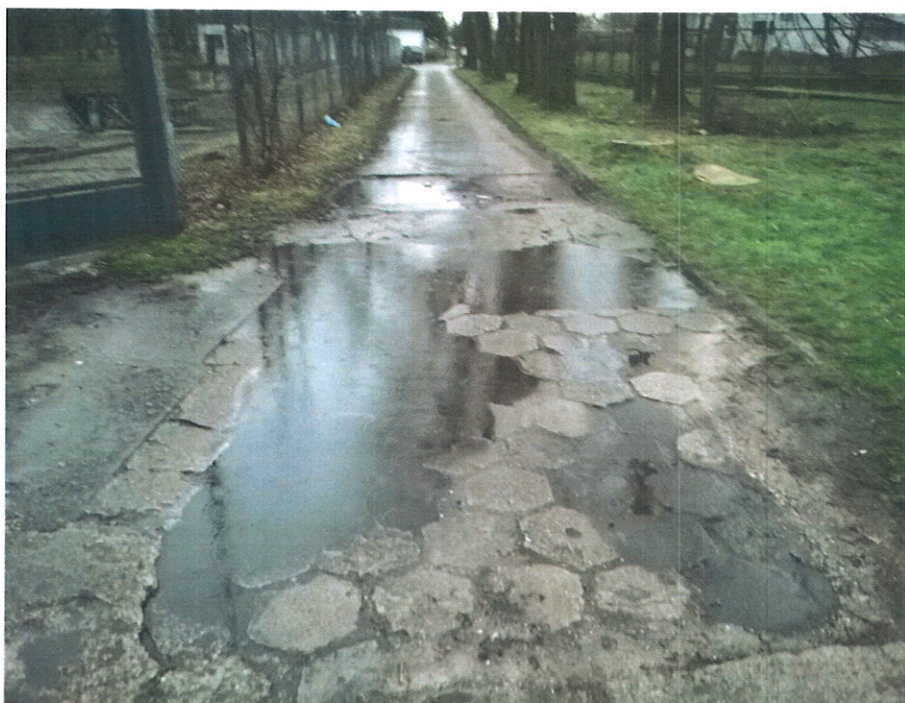
Ryc.3. Zdewastowana nawierzchnia przyległej do terenu opracowania uliczki (materiał fotograficzny własny)
